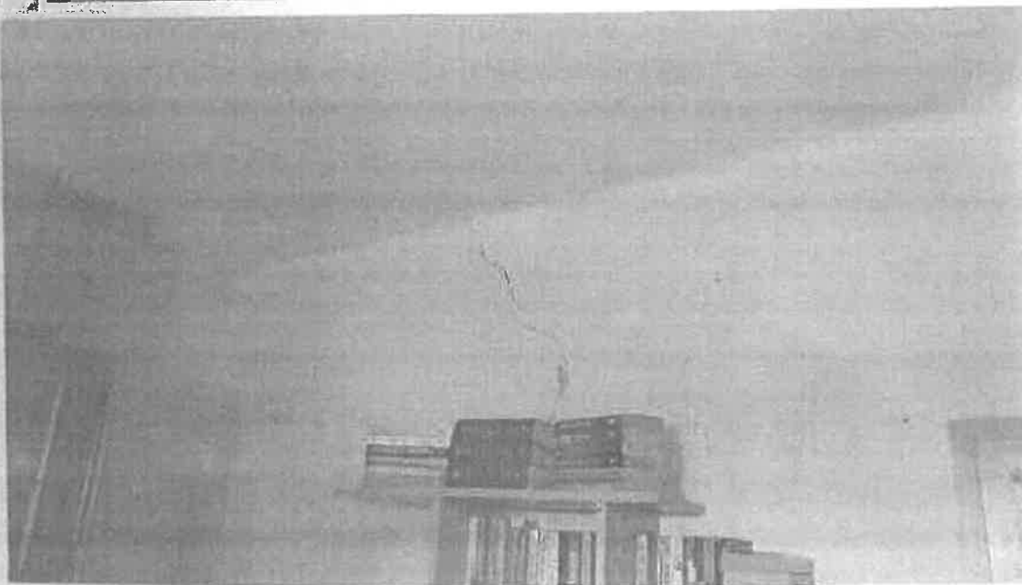
1. kép: Lakásban kialakult repedések
